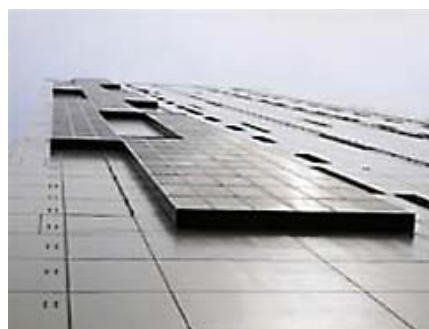
■東京第5センターに設置した太陽光パネル
