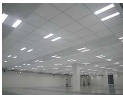
■データセンターのLED照明
