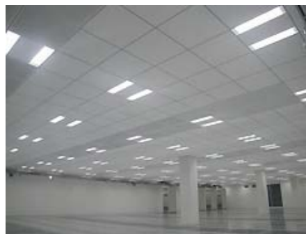
■データセンターのLED照明
