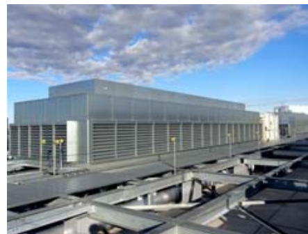
■ 空調室外機 屋上モジュールチラー
