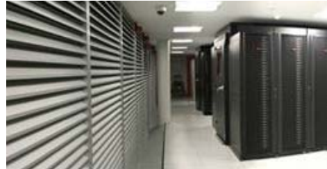
■ 壁吹き出し空調システム
