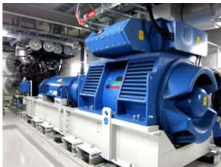
■ ロータリーUPS
