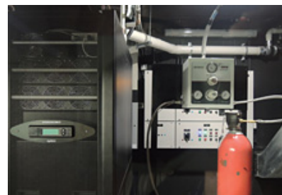
■燃料電池を用いたUPS
