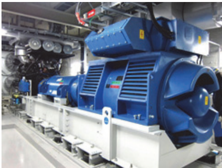
■ロータリーUPS
