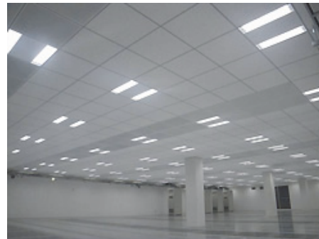
■データセンターのLED照明
