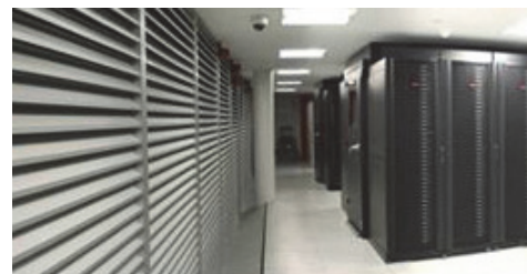
■壁吹き出し空調システム
