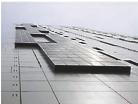
■東京第5データセンターに設置した太陽光パネル
