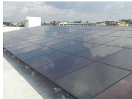
■マレーシアのデータセンタービルの屋上に設置した太陽光パネル
