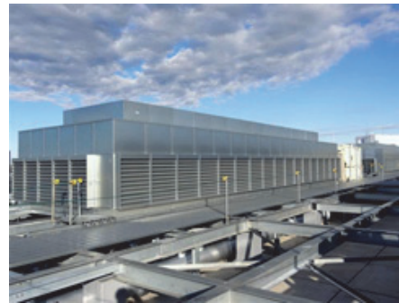
■空調室外機 屋上モジュールチラー
