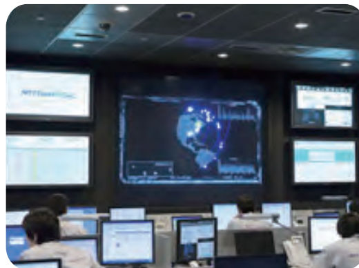
セキュリティオペレーションセンター
