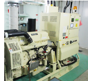
【局舎非常用発電装置】
